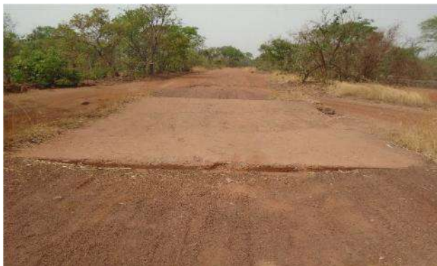
Photographie 4 : Revêtement dégradé (Source : Rapport APS, 2021)
