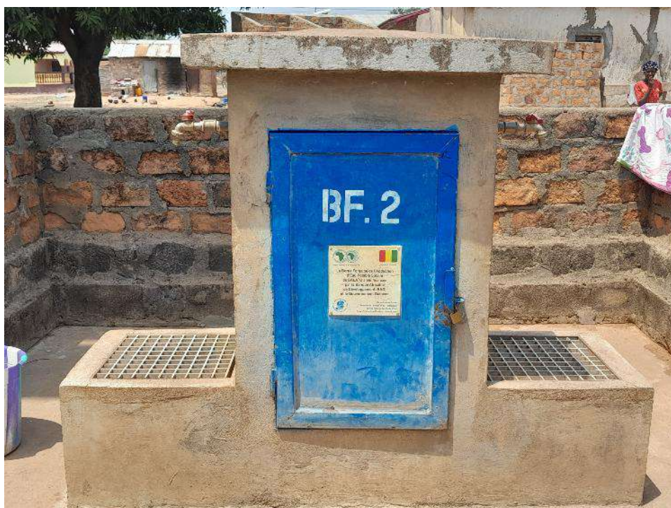
Photographie 52 : Borne de forage à Balato, Source : Insuco, 2025
