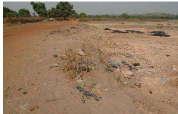
Photographie 5 : Etat actuel de la route présentant une dégradation du sol
