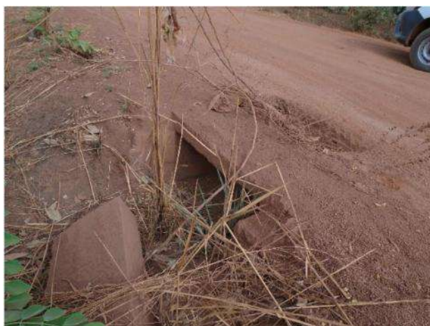
Photographie 6 : Gouttière ancienne en mauvais état (Source : Rapport APS, 2021)
