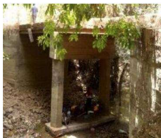
Photographie 7 : Pont sous-dimensionné (Source : Rapport APS, 2021)
